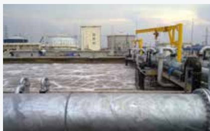
越南河内污水处理 污水处理厂 Yen So Park 处理河内污水的 50%。安装了 90 多台变频器，其中 12 台 450 kW VLT® AQUA Drive 用于控制风机。
